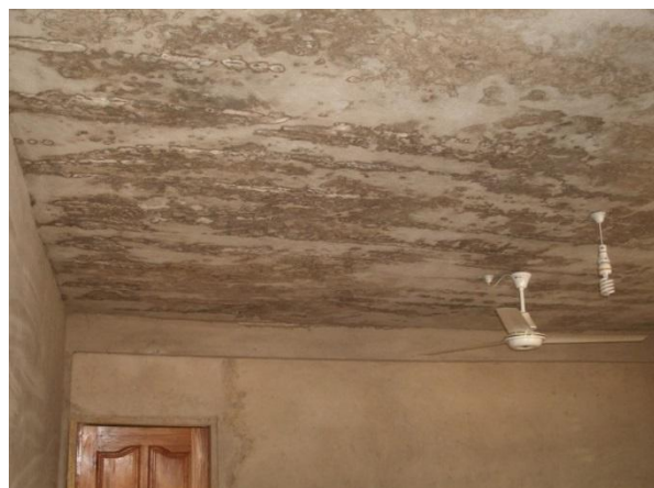
Geen dak, dus vochtige plafonds
